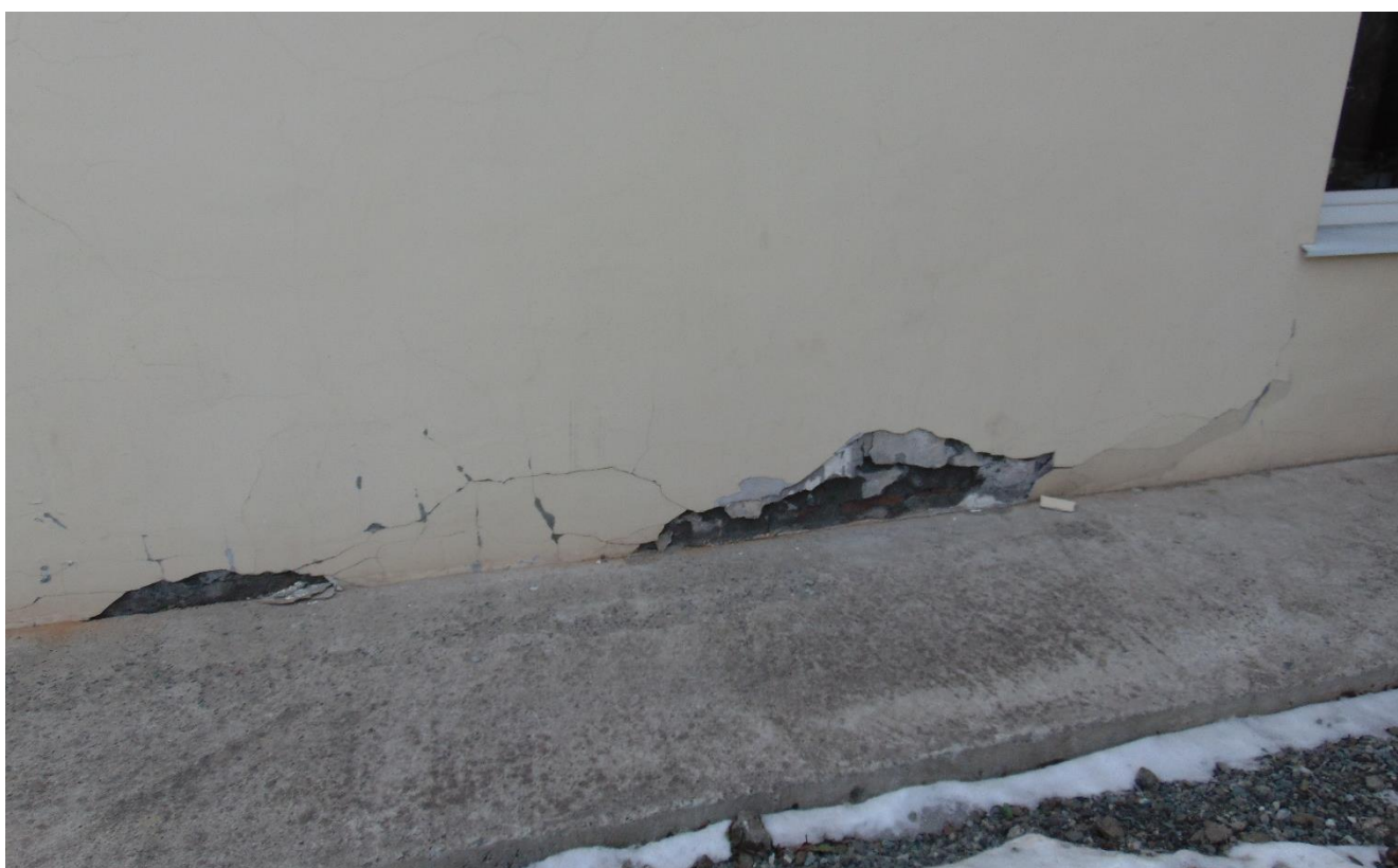
Фото 15. Повреждения отделочных слоев цоколя
