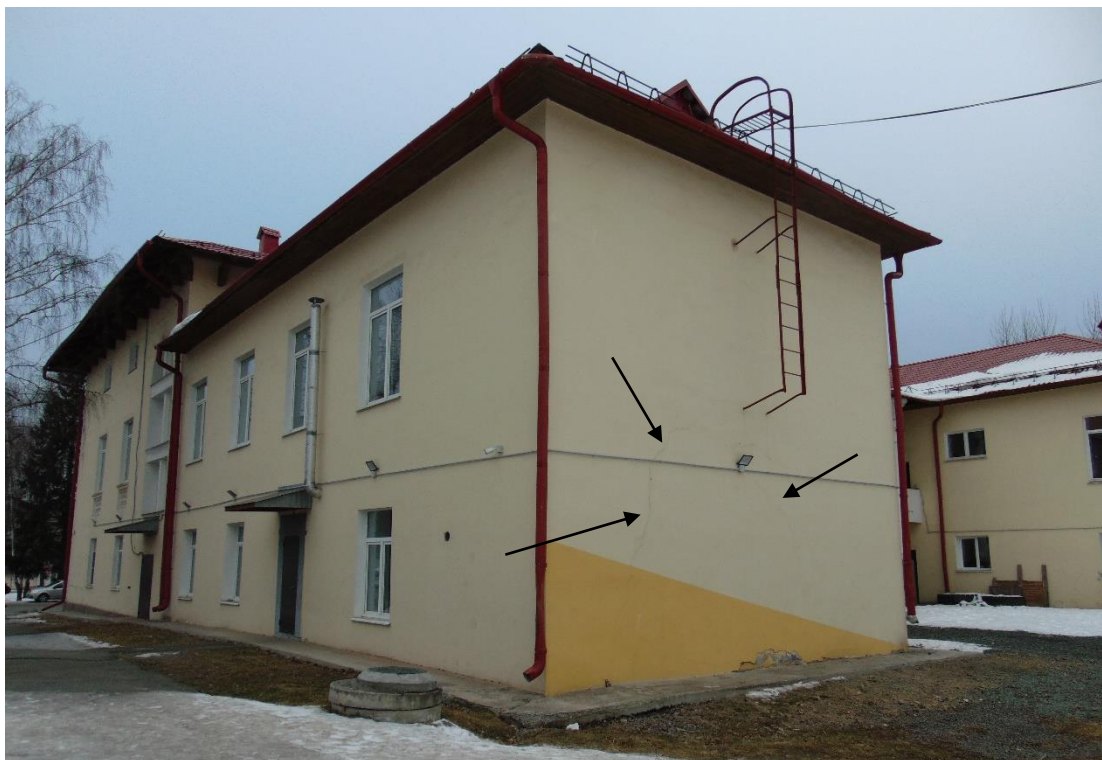
Фото 13. Трещина в наружном слое кладки
