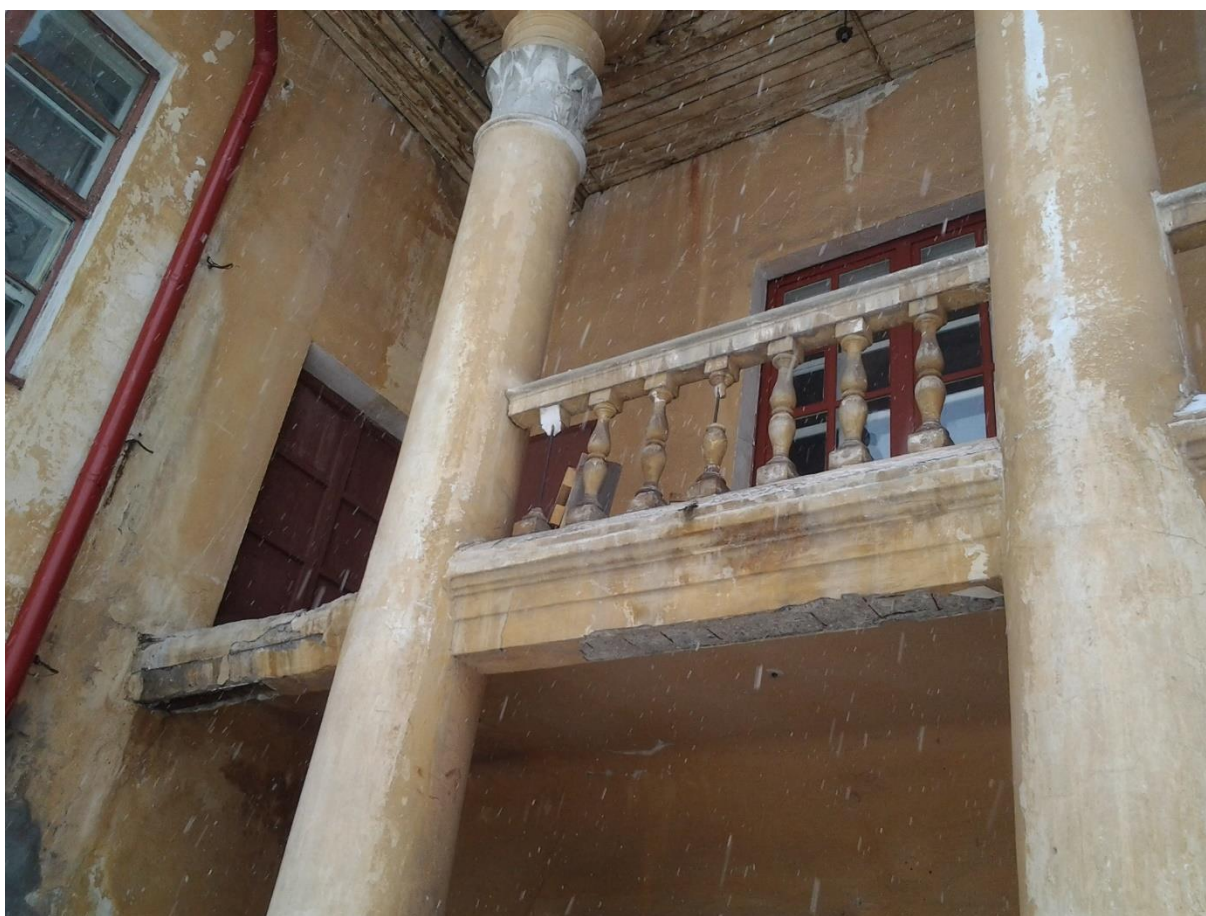
Фото 21. Балкон Литера а1 (фото 2014 года, предоставлено работниками дворца)
