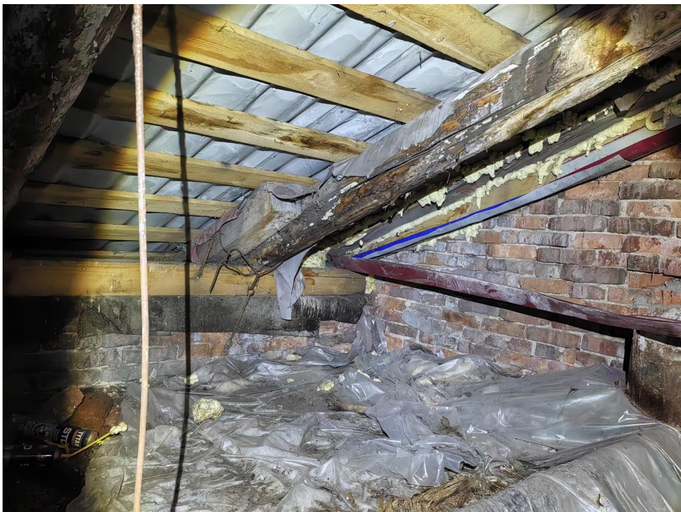
Фото 22. Сырость чердачного перекрытия над помещением №1 (хореографический зал), третий этаж
