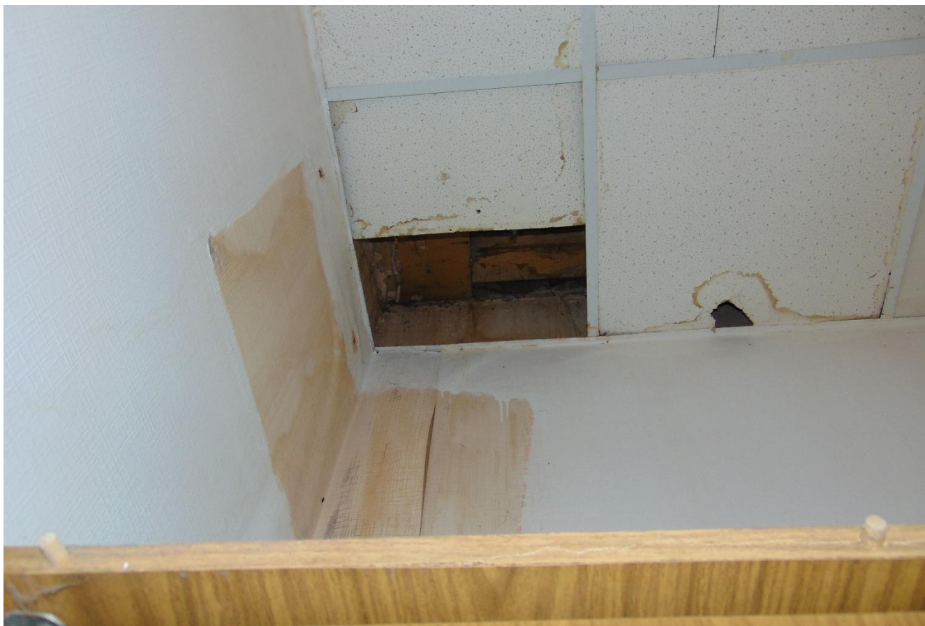
Фото 21. Следы протечек на потолке помещения №1 (хореографический зал), третий этаж
