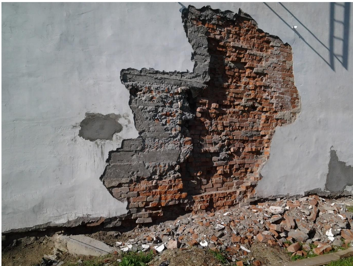
Фото 14. Разрушение наружного слоя кладки стены (фото 2014 года, предоставлено работниками дворца)
