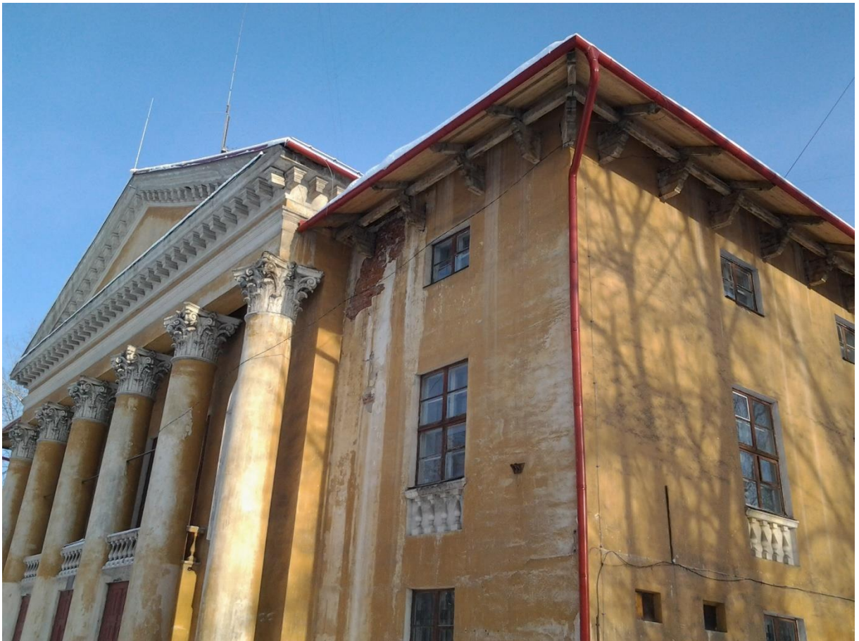
Фото 19. Повреждение кладки в месте протечек с кровли (фото 2014 года, предоставлено работниками дворца)
