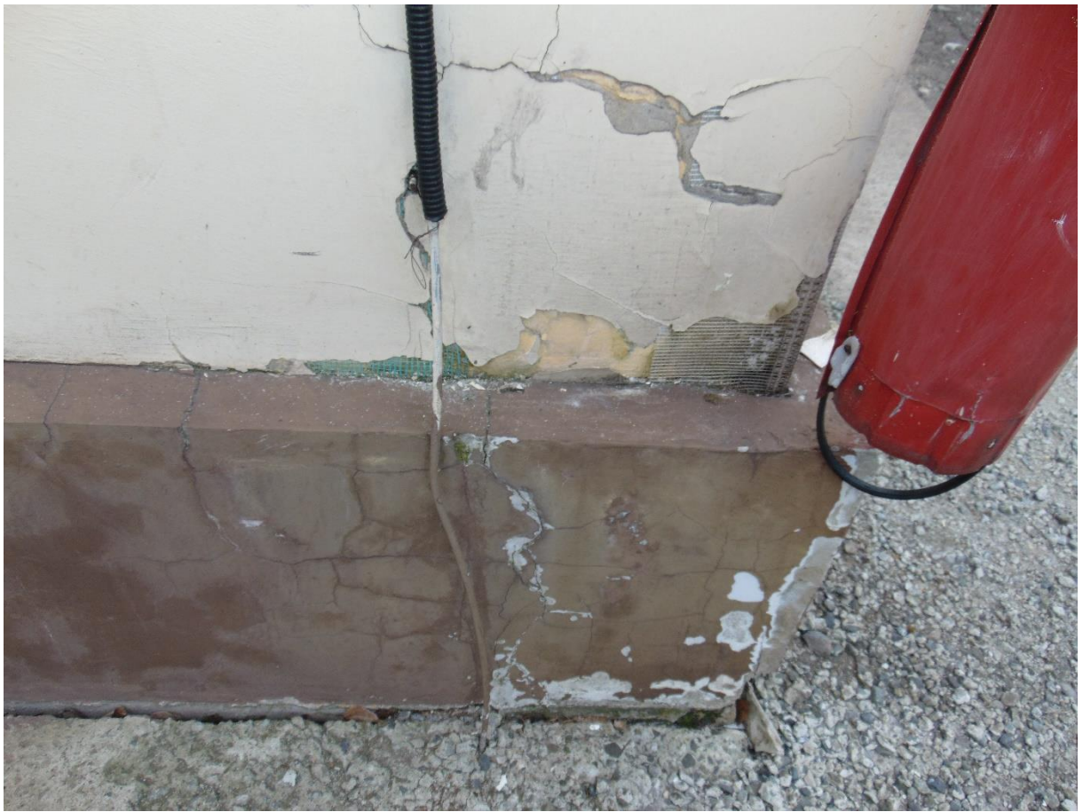
Фото 16. Повреждения отделочных слоев стен и цоколя
