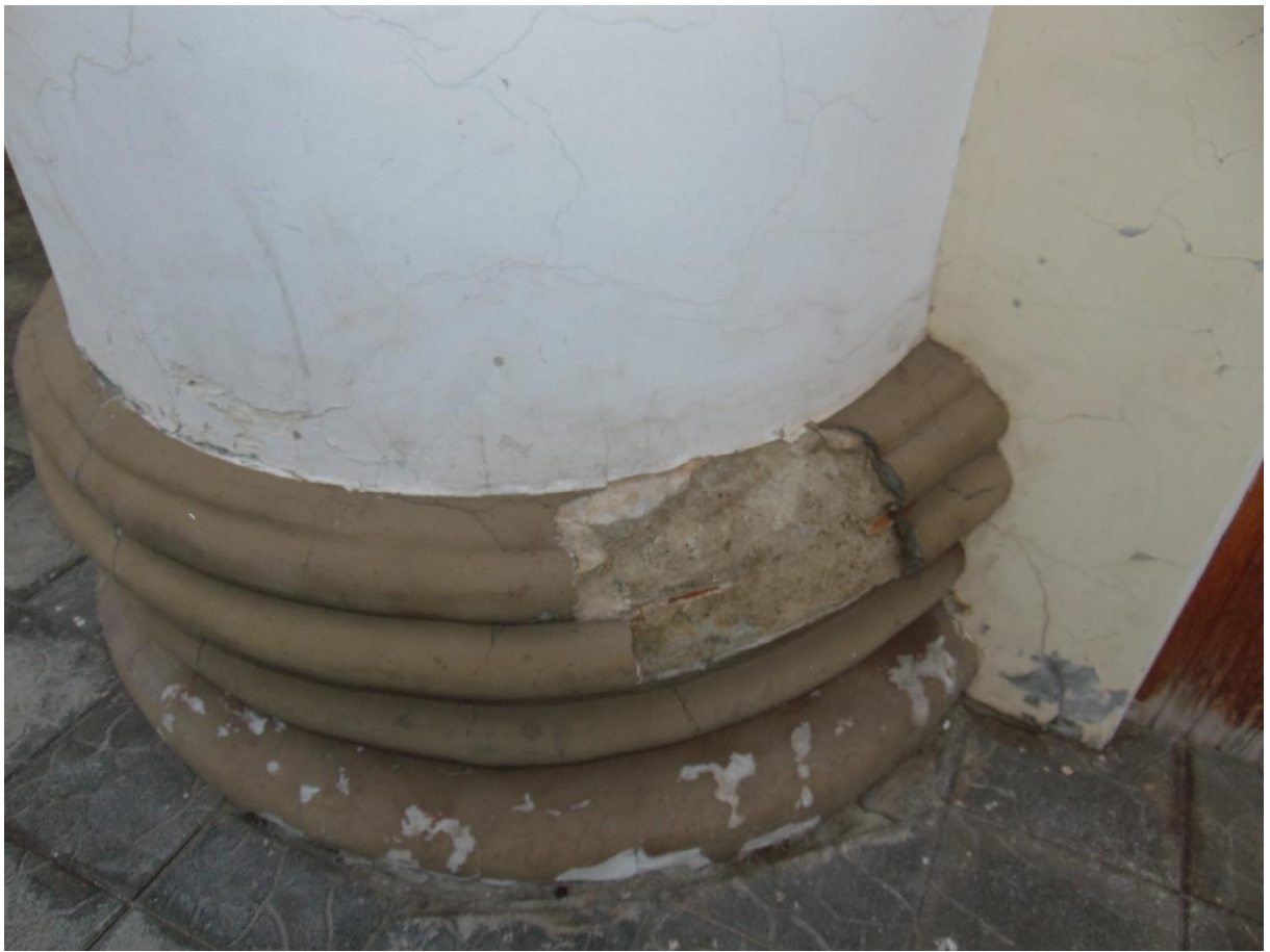
Фото 18. Повреждение штукатурного слоя колонны
